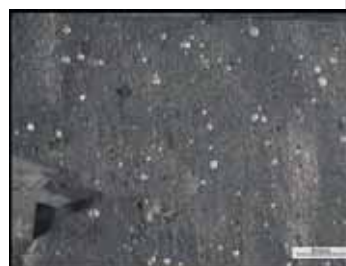
Fig. 13 - Superficie area danneggiata Surface of damaged area
