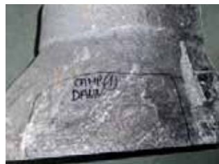
Fig. 2 - Area danneggiata / Damaged area
