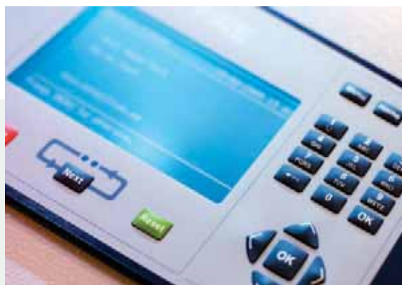
Fig. 4 - Il pannello centrale di segnalazione allarme incendio Salwico Fire alarm central panel Salwico
